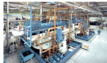
4 - Centrais de Filtragem de Óleo
