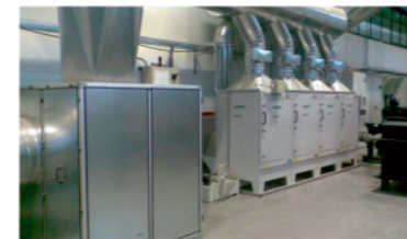
5 - Centrais de Filtragem de Névoa de óleo e Despeiramento
